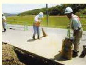
舗装に漏れた作動油に現場で備蓄していたオイルゲーターを撒き、油吸着させている状況。
