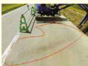
バックホーの作動油のホースが破裂して、舗装の上に漏れている。
