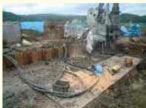
特殊油圧機械の油圧ホース破損により作動油流出
